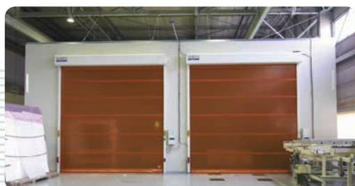
・テスト用クリーンルーム
